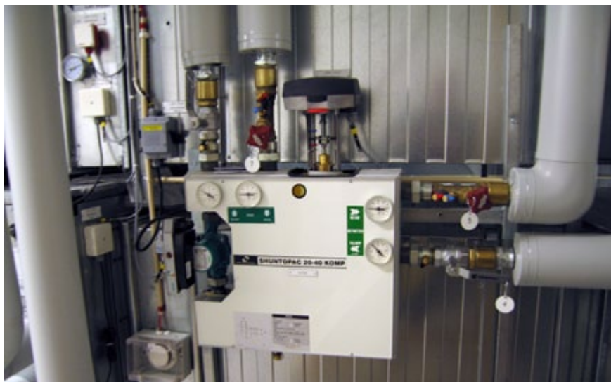
Teknikutrymme vid Lundbyskolan. Källa: Kommunfastigheter, Örebro.
